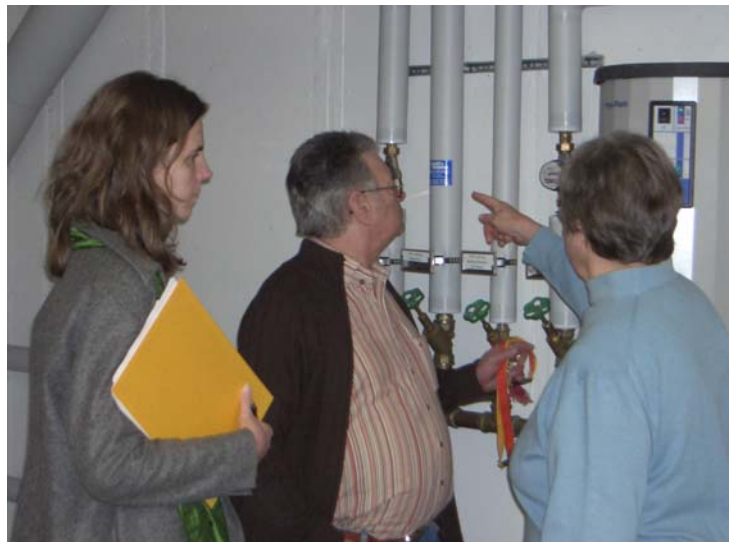
Internes Audit, Besichtigung des Heizungskellers im Kindergarten Sonne
